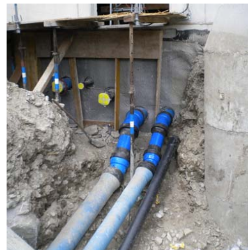
Zuleitungen vom Reservoir ins Dorf
