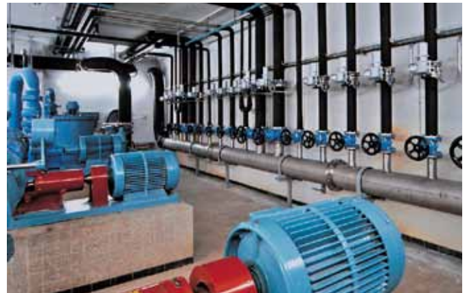
Kühlwasserleitung, KW Mattmark, Stalden
