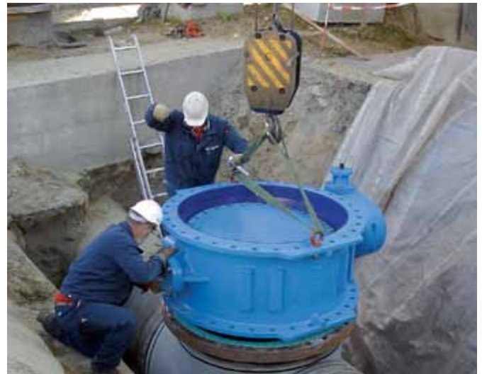
Rhone-Kühlwasserleitung, Lonza AG, Visp
